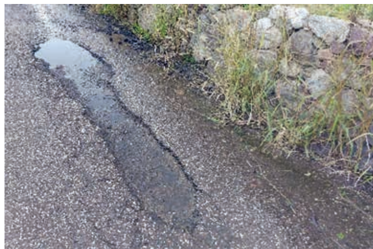
Zustand der Wartung in der Plantasstraße
